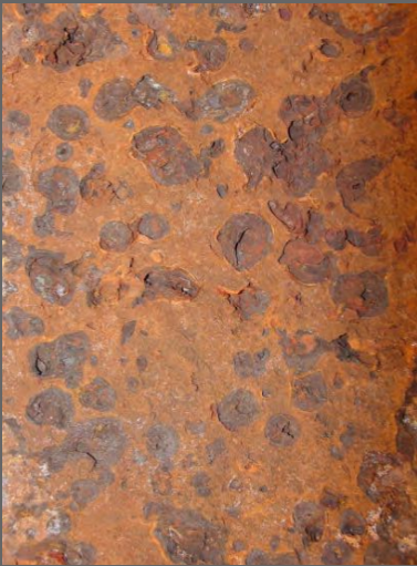
Yüksek tuz seviyeleri için lokal korozyon
