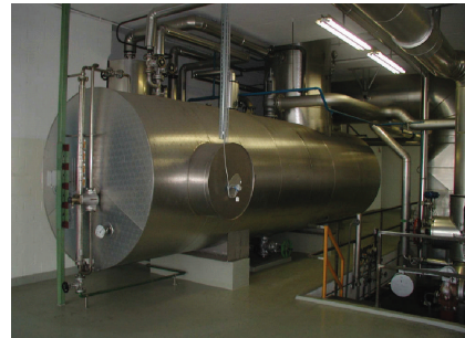
fiakil 9. Düşük basınçlı gaz alma sistemli besi suyu tankı.
