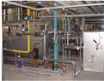
Şekil 7. Kazan›n arkas›na yerleştirilmiş ekonomizör uygulaması.
