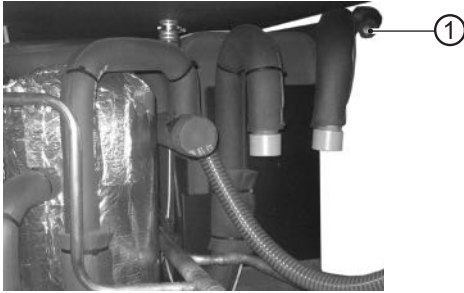
1 Ünite üzerindeki hidrolik bağlantıların üzerinde havalandırma valfi
